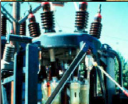
Figura 1. Tres fases de un Circuit Braker lleno de aceite (OCBs) visto desde la parte exterior (imagen izquierda) y desde la parte interior (imagen derecha) con el aceite drenado. En esta última se muestra la estructura y contactos del mismo.
