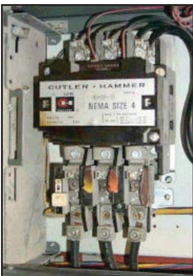
Figura 7: Arrancador de motor compuesto por un contactor y protecciones de sobre carga. El patrón térmico normal debería mostrar la bobina tibia.
