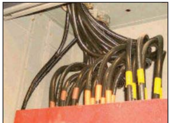
Figura 1: Cables de alimentación principal de un CCM.
